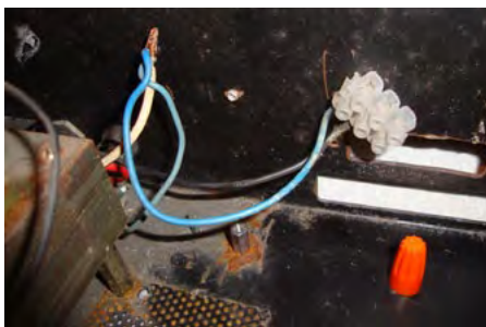
Loses Stromkabel: ein Sicherheitsrisiko
